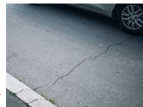
亀裂の入った駐車場
